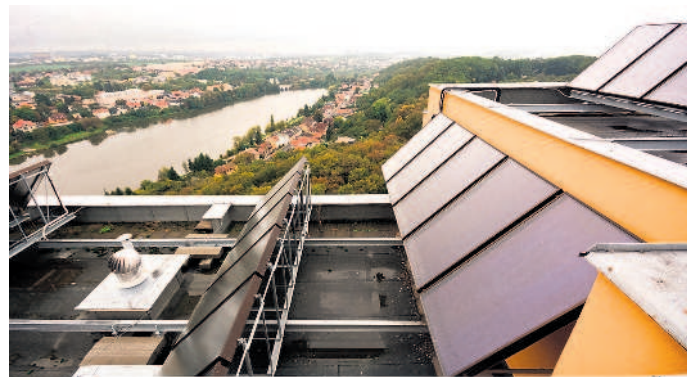
Solární panely na střechách v pražském Hloubětíně.
