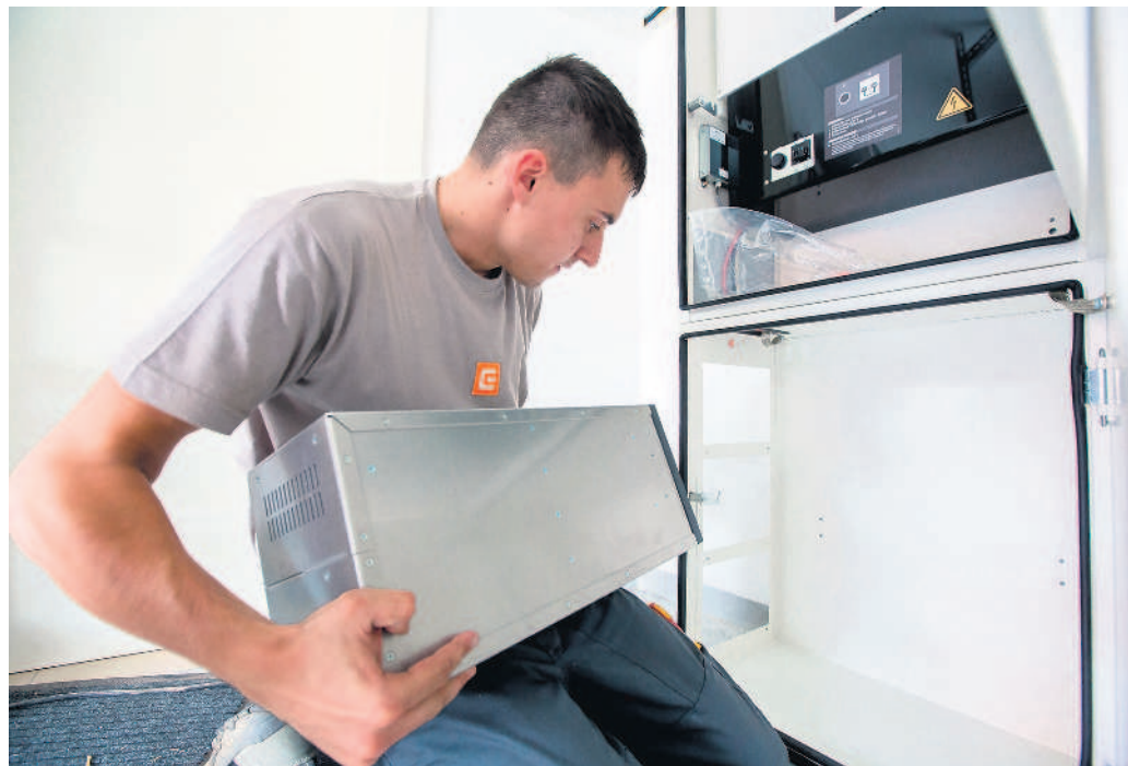
Instalace bateriového systému Sonnen u prvního zákazníka v Česku. Foto: ČEZ (2x)
