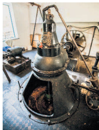
Penzion zásobuje elektrinou také malá vodní elektrárna.
